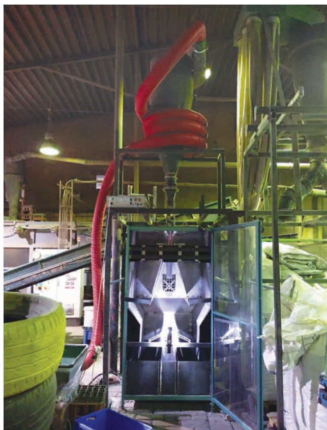
Pohled do vysokonapěťové komory průmyslového prototypu
